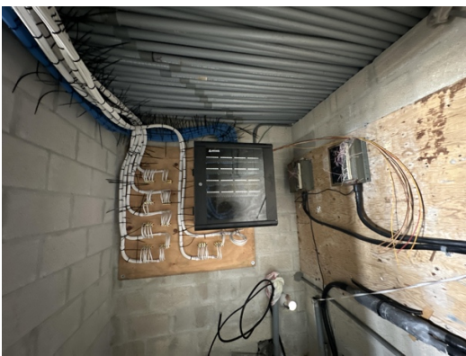
New Cat 5 Wiring
